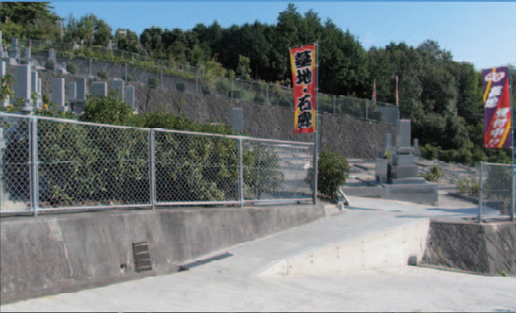
下段からお参りしやすいように入口とゆるやかなスロープを新設しました。
